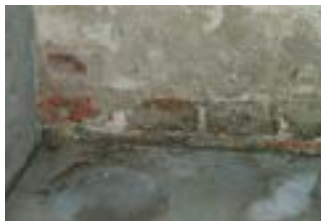
Subsol cu deteriorări cauzate de umiditate
