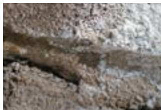
Urme de sare cu efect distructiv
